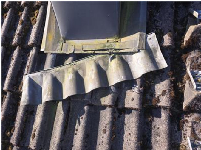
Plåt som släppt vid plåthuv.
