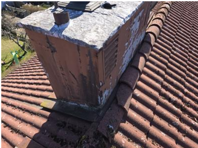
Exempel på takpannor som täcker bristfälligt vid skorsten.
