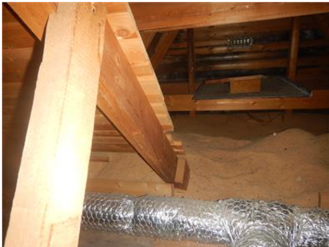
Mikrobiell påväxt på gavelspets.
