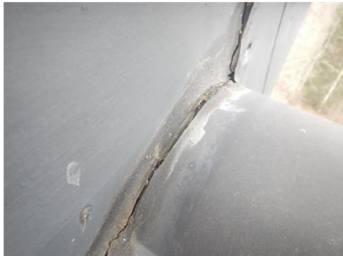
Otätthet mellan skorstensbeslag ochnockplåt.
