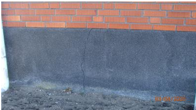
Sättningar i grundmur
