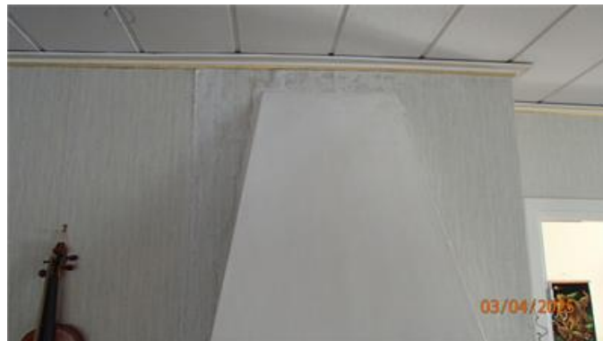
Fuktmärken vid murstocken
