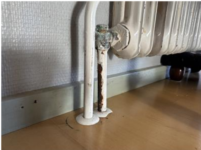
Det finns äldre VVS i huset.
