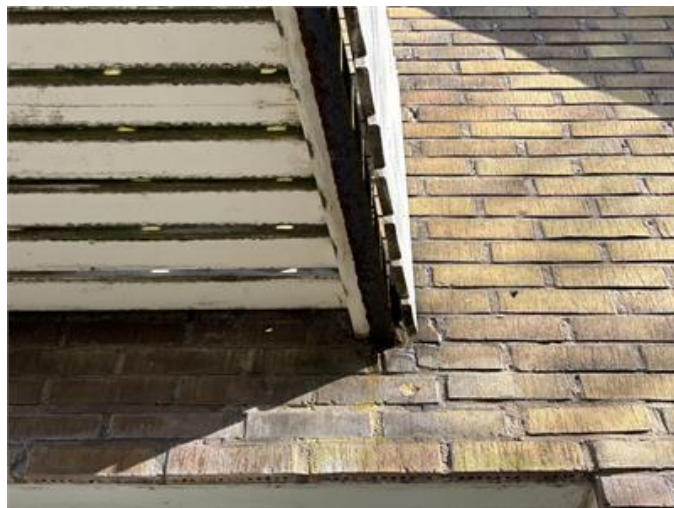
Tydliga rostangrepp finns på balkongkonstruktionen.
