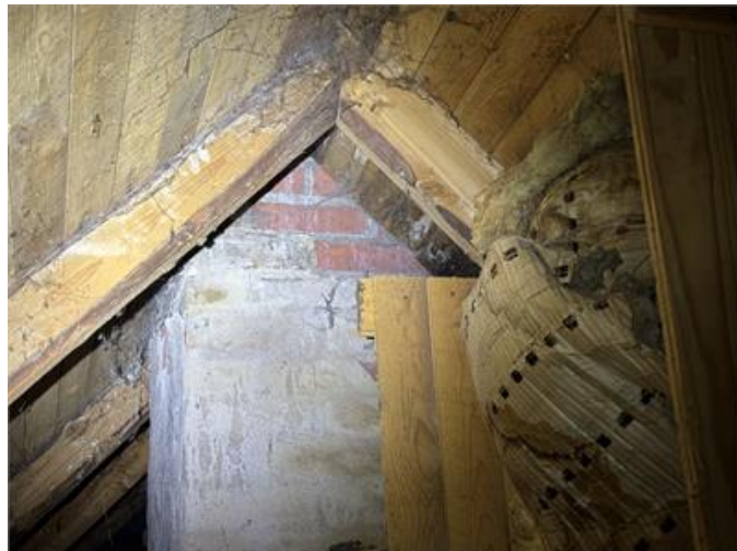
Fuktfläckar finns på vinden, bland annat i anslutning till murstock.
