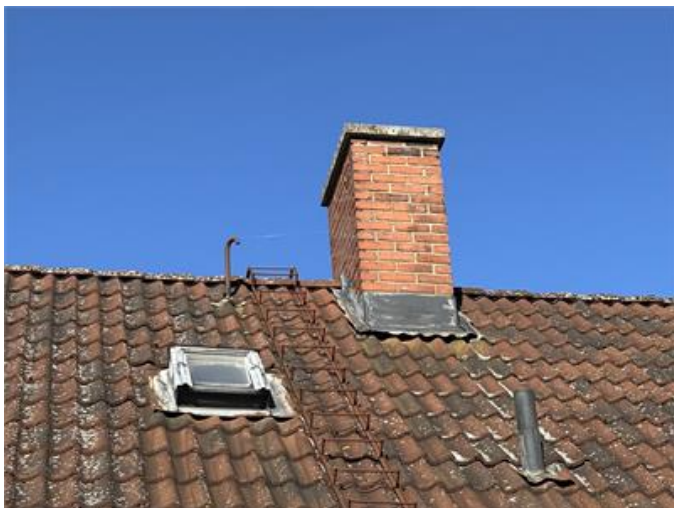
Färgsläpp/rostangrepp finns på plåtdetaljer. Skorstenskjolen sluter inte tätt mot takpannorna. Väderskydd saknas på skorstenen.
