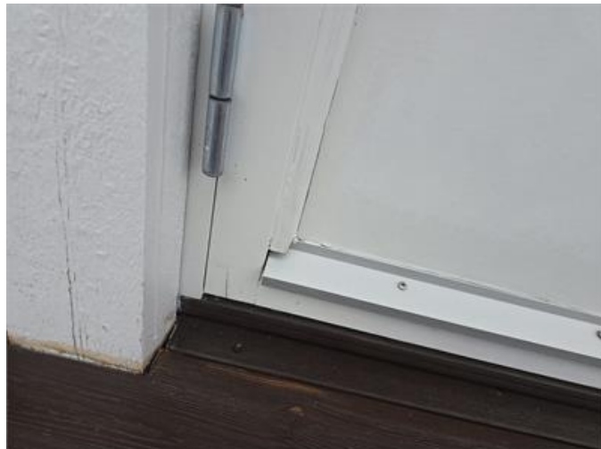
Begynnande målning/underhållsbehov altandörr.
