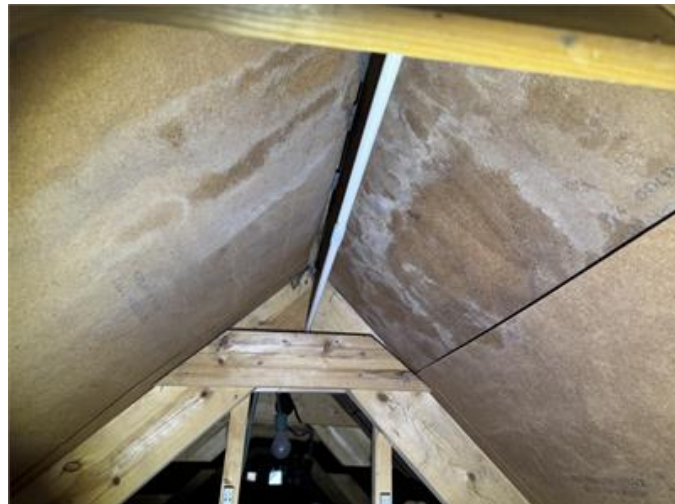
Missfärgningar på vindens underlagstak.
