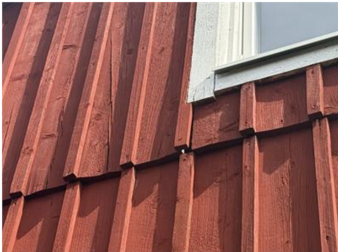
Lockläckt har lossnat från infästning.
