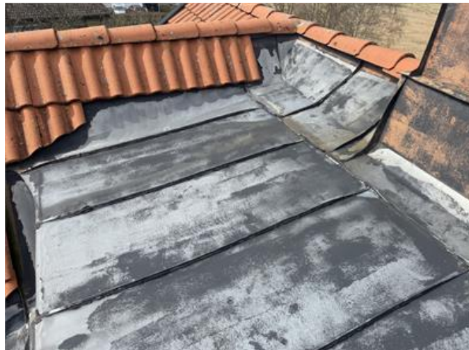
Färgsläpp förekommer från plåttaket.
