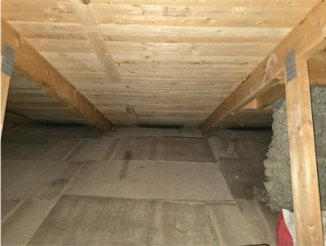
Nockvind: Ytlig mikrobiell påväxt på underlagstag samt isolering som delvis ligger an mot underlagstag.
