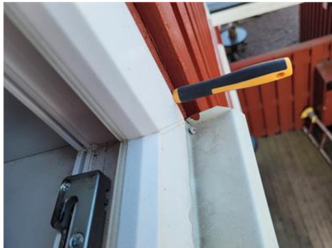
Otättheter mellan fönster och fasad.
