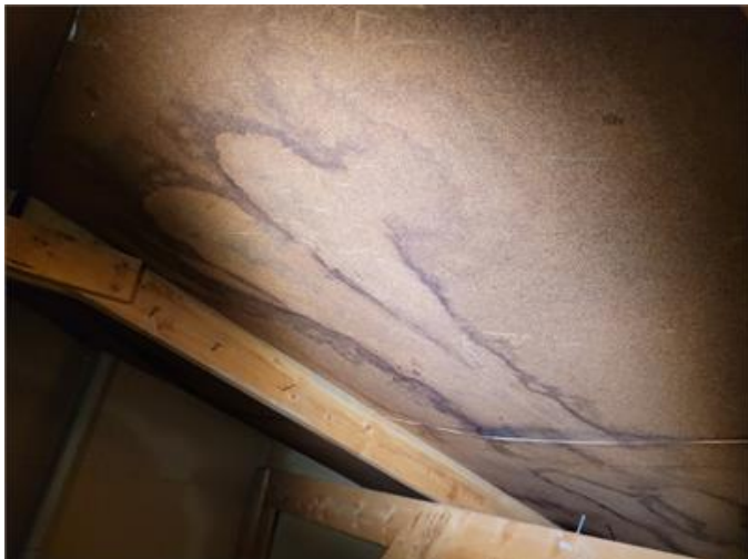
Fuktfläckar på underlagstak
