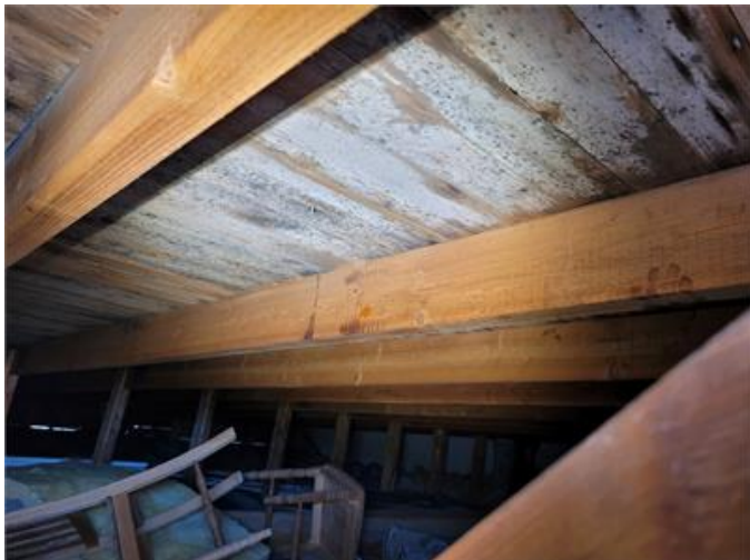
Mikrobiell påväxt på underlagstak.
