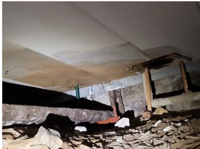
Fuktskada i krypgrunden
