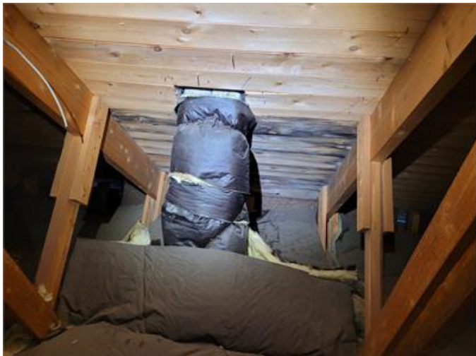
Fuktfläckar på underlagstak.
