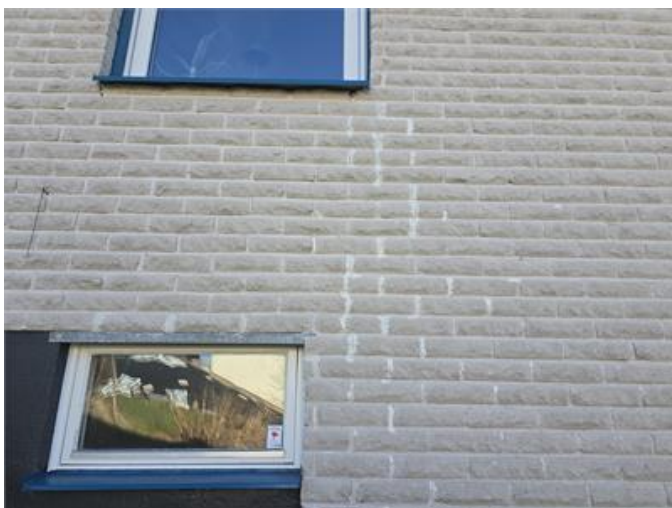
Exempelbild, sprickor i kalksandstensfasad.
