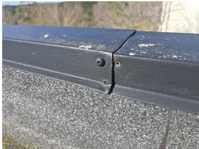
Exempelbild gamla skruvhål, plåtarbeten sarg, tak.
