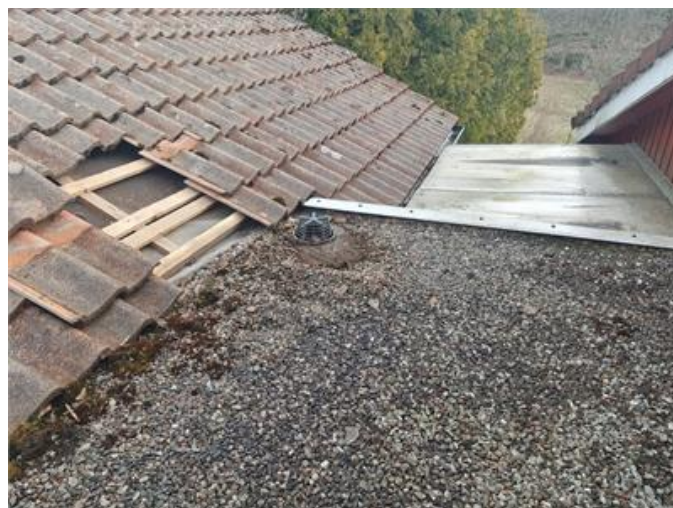
Tak ovan Tvätt, låglutande med gummiduk och brunn/stuprör.
