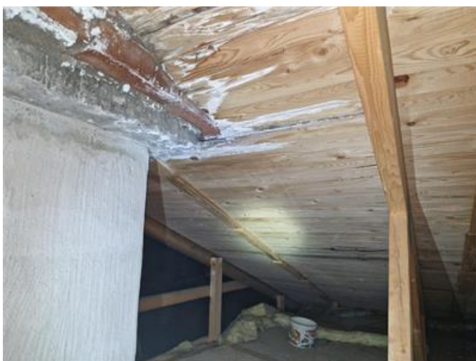
Nockvind, fuktgenomslag vid och nedan skorsten.
