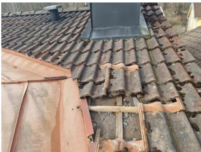
Tak, original och passerat beräknad teknisk livslängd, kontroll under pannor där läckage fläckar finns på vinden.
