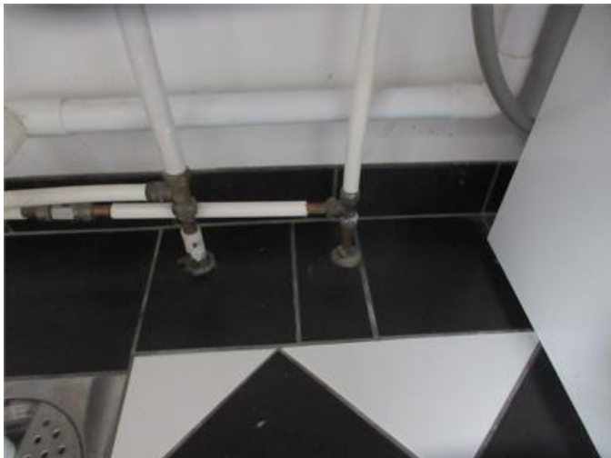
Rör genomföring i våtrumsgolv
