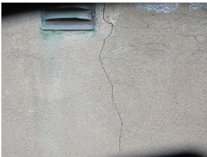
Spricka i sockeln
