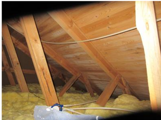
Mikrobiell påväxt på insida yttertakets på vinden
