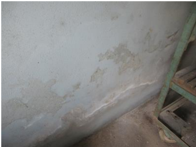
Salt & kalkutfällning på källarvägg
