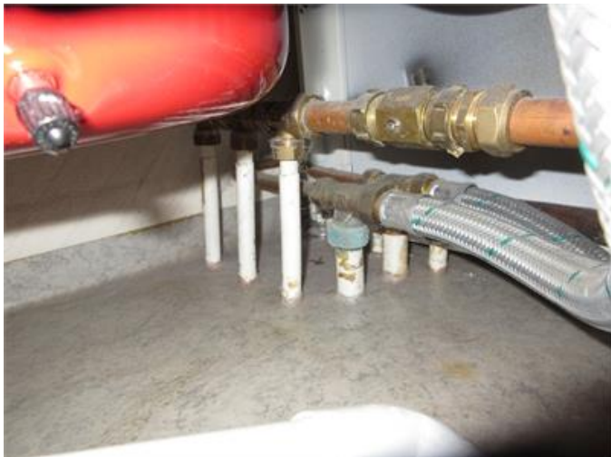
Rör genomföringar i våtrumsgolv
