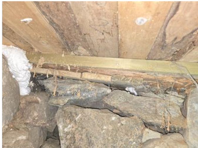
Exempel på rötskador i torpargrund.
