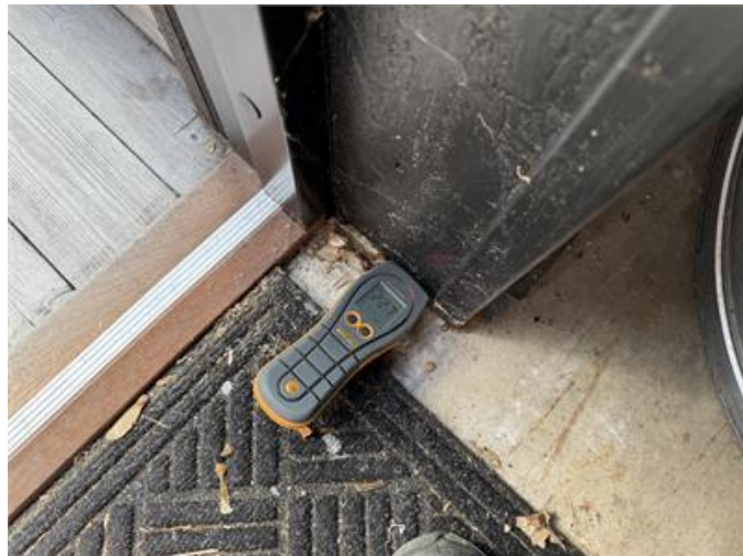
Något förhöjda fuktvärden uppmättes i garageväggens nederkant (intill betongplattan).
