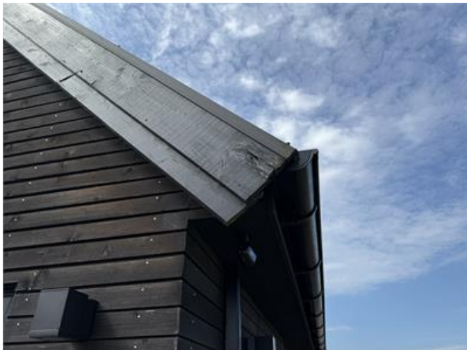
Rötskador noterades i vindskiva.
