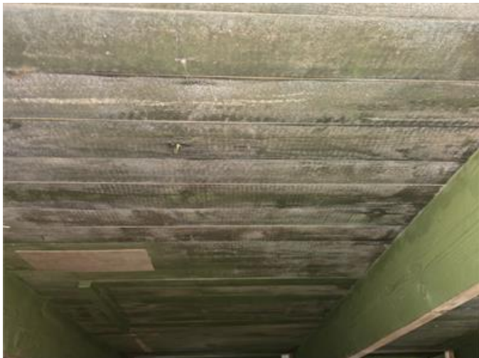
Nockvind: Mikrobiell påväxt.
