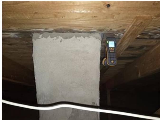
Exempel på fuktfläckar i underlagstak.
