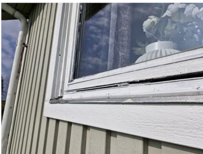
Fönster, underhåll alt delvis byte.
