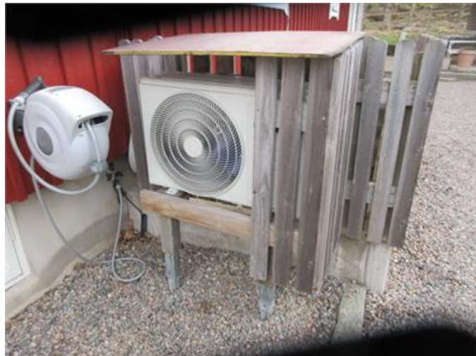
Luftvärmepumpen på fasaden
