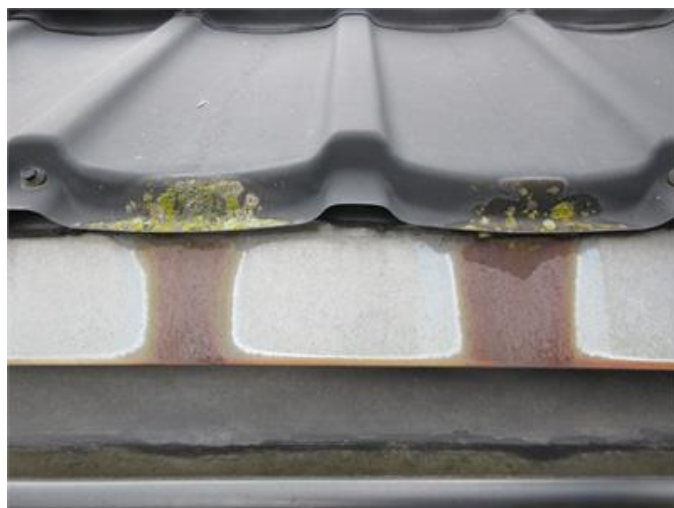
Rostig plåt på garagetaket
