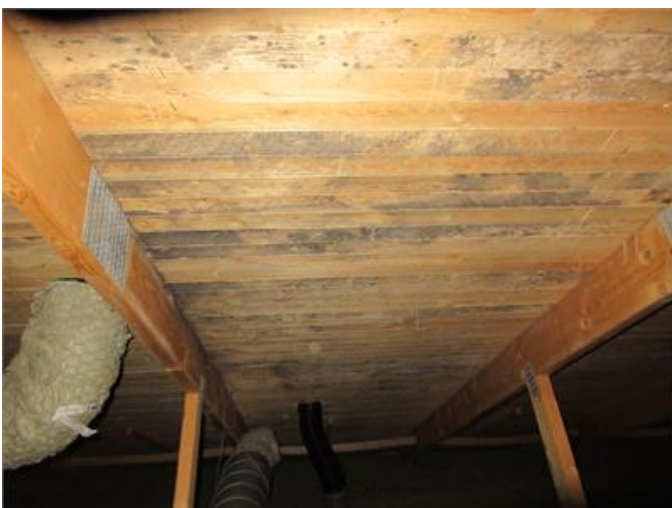
Mikrobiell påväxt på vinden
