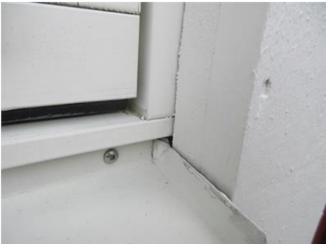
Otät infästning av fönsterbleck
