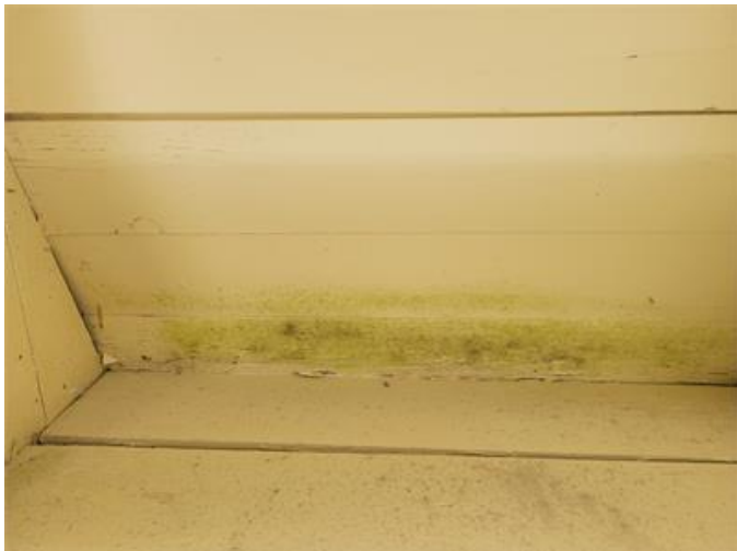
Missfärgning i takfot/taksprong.
