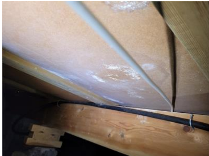
Mikrobiell påväxt på blindbotten.
