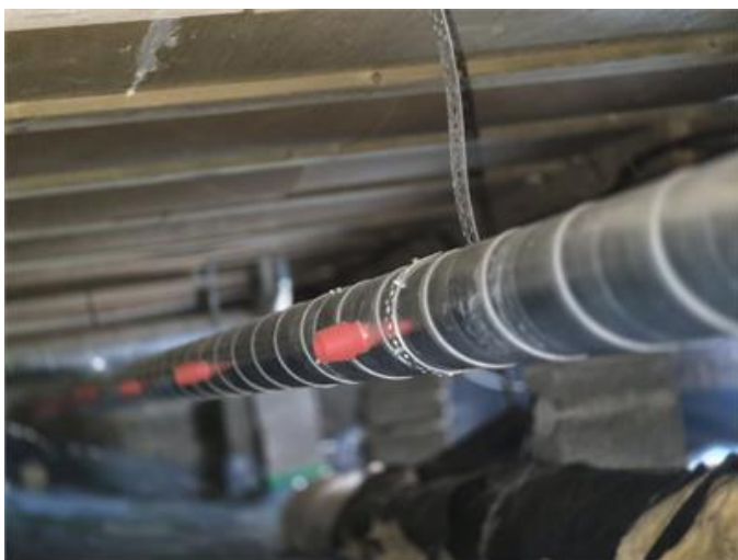
Del av den nya installationen i krypgrunden.
