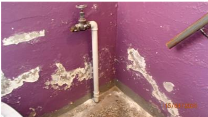
Fuktgenomslag på källarvägg.
