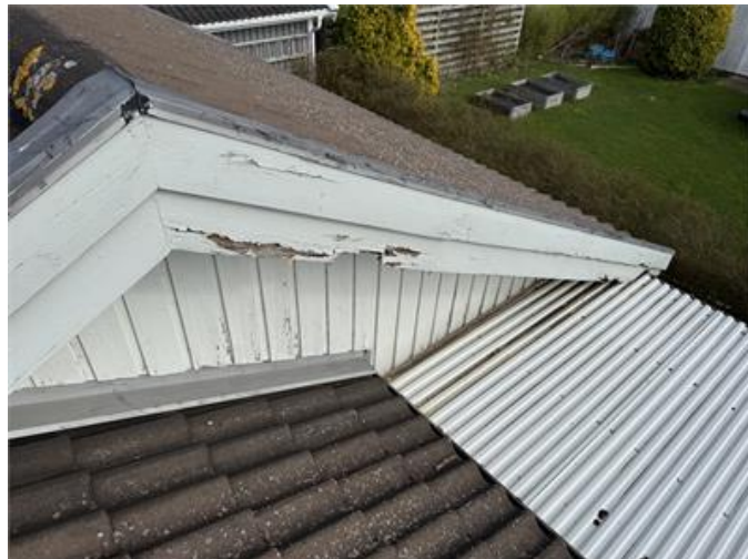
Rötskador noterades i vindskiva.
