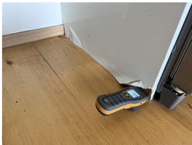
Tecken på historiskt läckage noterades i täckskiva intill kylskåpet. Inga förhöjda fuktindikationer påvisades.
