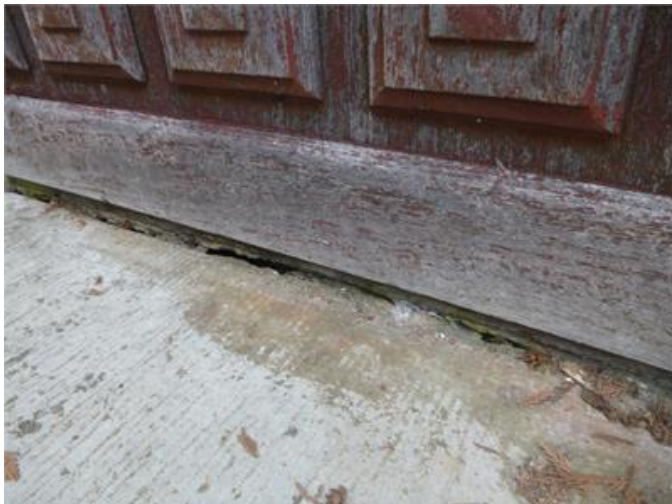
Rötskador kring entrédörren
