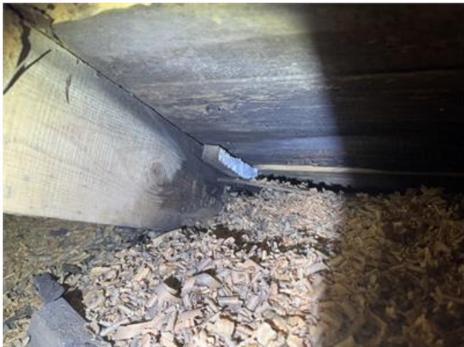
Rötskador i övre del av takstol på vindsutrymmet.
