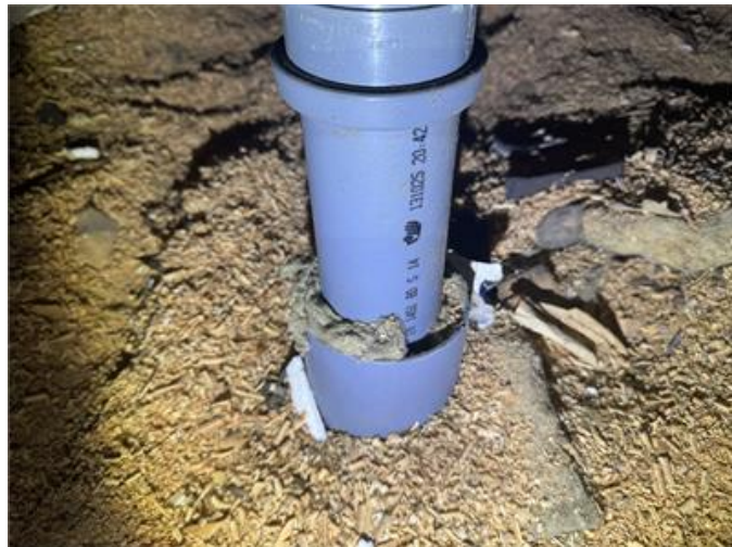
Otättheter vid skarv på avloppets avluftning på vindsutrymmet.
