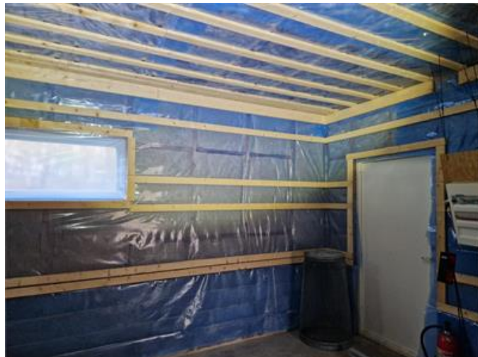
Garage: Insida ej färdigställd.
