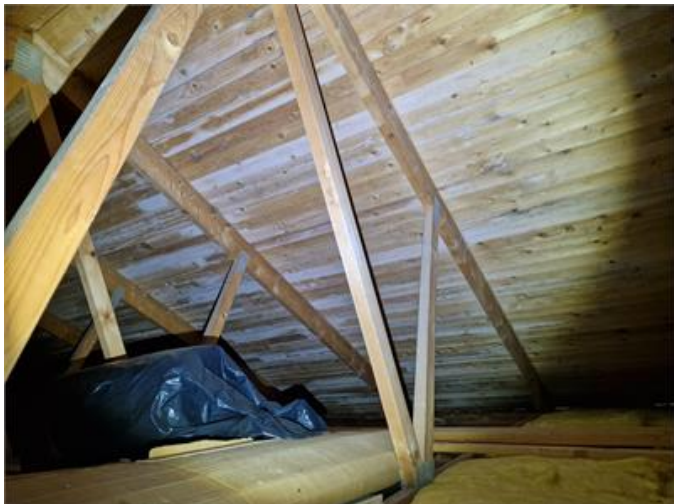
Garage: Mikrobiell påväxt förekommer på underlagstakets undersida
