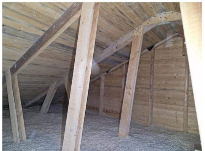
Nockvind, viss mikrobiell påväxt i underlagstaket södra delen.
