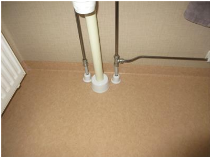
Rör genomföring i våtrumsgolv
