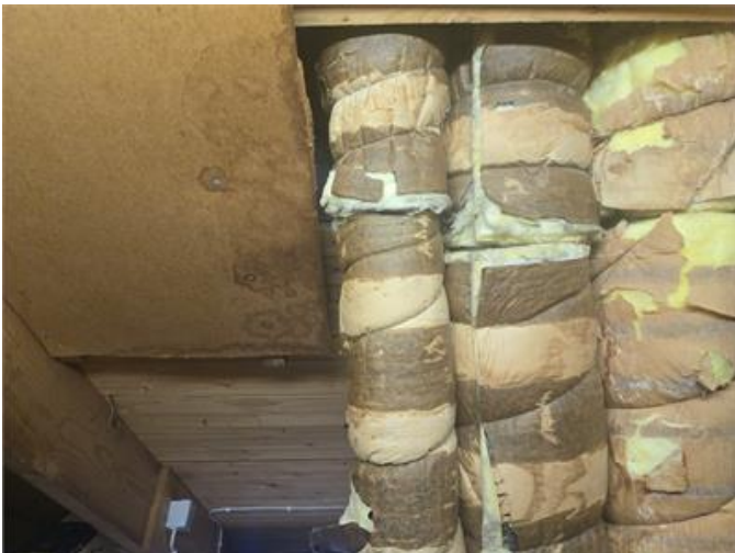
Exempelbild, fuktfläckar underlagstak kring genomföring, vind.
