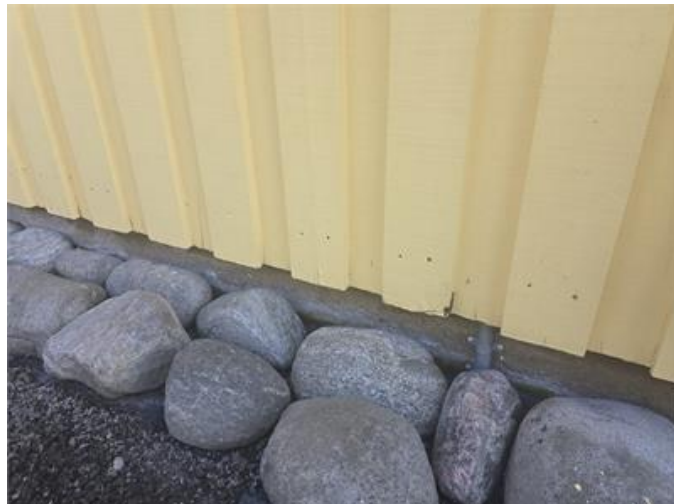
Exempelbild, lokal rötskada fasadpanelens underkant.
