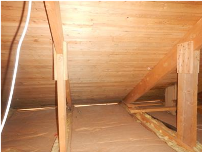
Mikrobiell påväxt på underlagstak vind.
