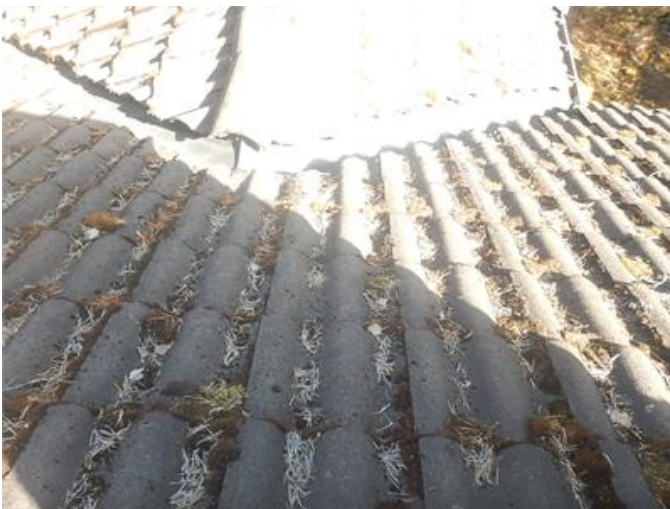
Mossa på takpannor.
