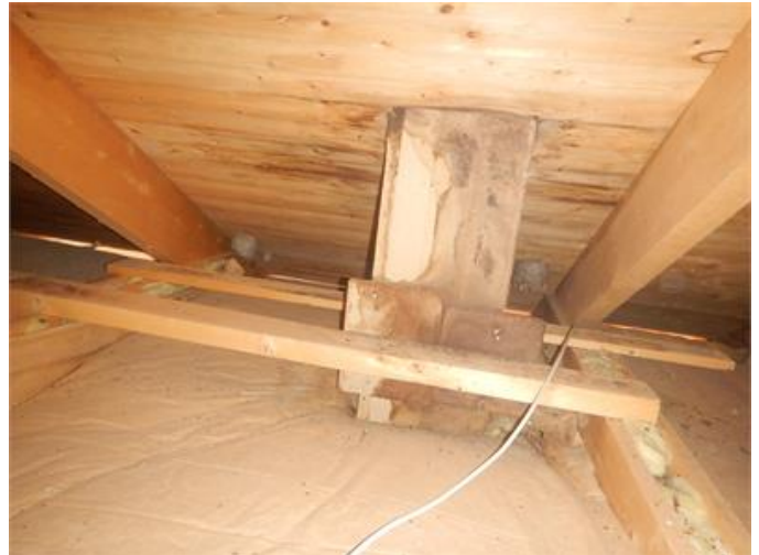
Fuktpåverkan på inbyggnad till köksfläkt vind.
