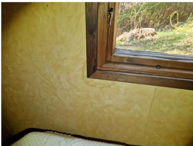
Sovrum 2: Fuktfleck noterades på vägg i anslutning till fönster.
