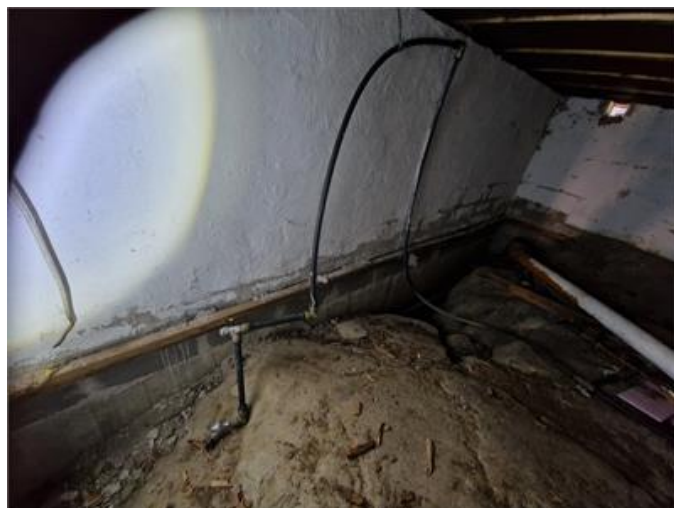
Krypgrund: Bristfällig vatteninstallation noterades.
