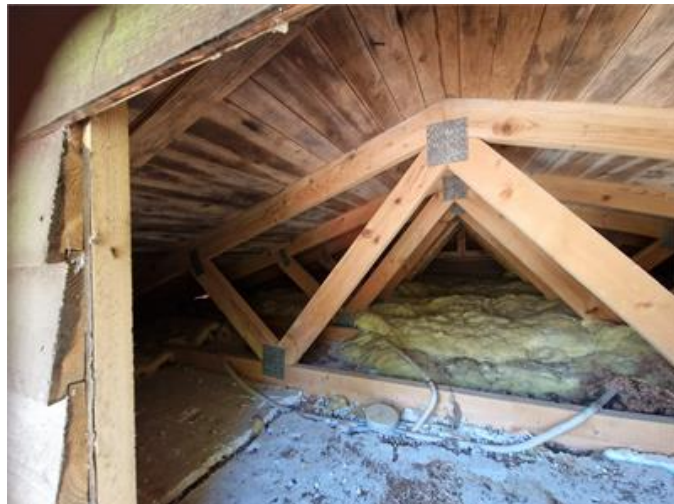
Vind - Lucka ovan entré: Mikrobiell påväxt förekommer på underlagstakets undersida,
