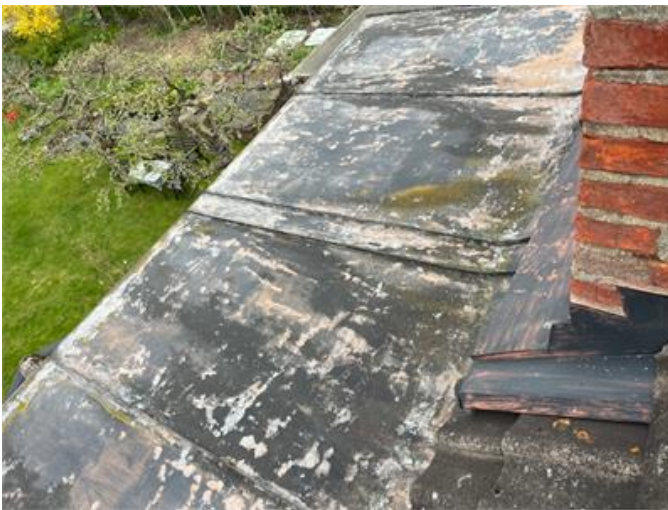
Plättaket över takkupan är låglutande, se protokollets näst sista sida pos. 1. Plåten är rostangripen.
