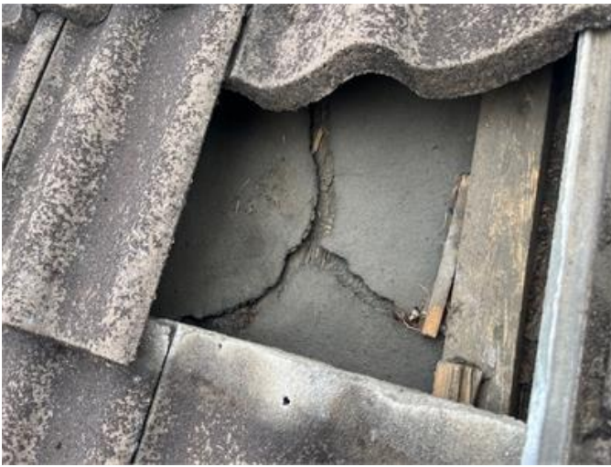
Tak ursprungliga- Vid stickprovskontroll av läkt och papp noterades sprickor i takpappen.
