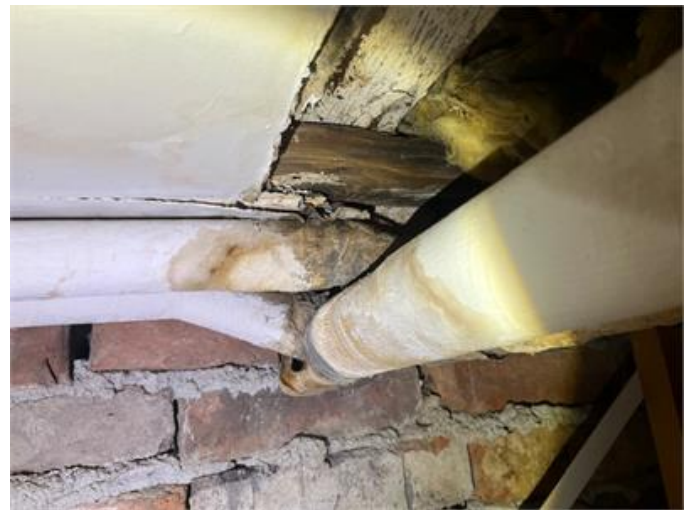
Lokalt i taket samt på isolering till rör förekommer missfärgning/fuktfläckar. Ingen förhöjd fukt uppmättes/indikerades vid besiktningen och därav går det ej att avgöra om det är pågående eller av äldre ursprung. Löpande kontroll rekommenderas då brister noterades i ovanliggande badrum.
