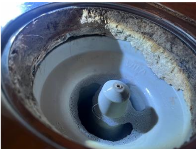
Manschett i golvbrunn bedöms vara felskuren och klämring bedöms ej sitta i sitt korrekta läge, vilket bör kontrolleras och ev. justeras av fackman.
