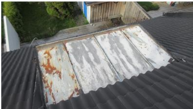
Bild som visar den rostangripna takplåten.
