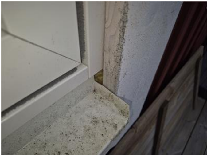
Otättheter vid fönsterplåt.
