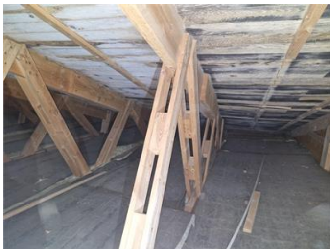
Nockvind, ljus och mörk mikrobiell påväxt i underlagstaket.
