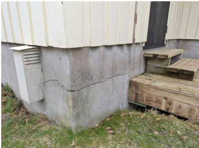
Sockel, spricka i sockel baksida garage.
