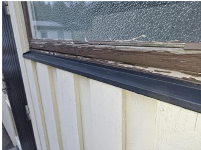
Fönster, äldre i behov av renovering alt byte.
