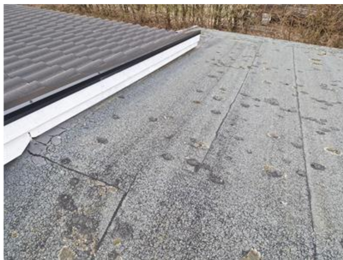
Tak Garage, äldre med krackeleringar och mossa/lav.
