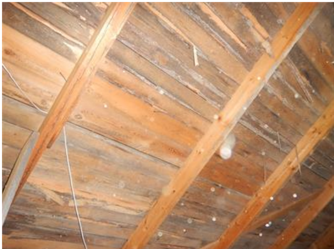
Mikrobiell påväxt på underlagstak vind.
