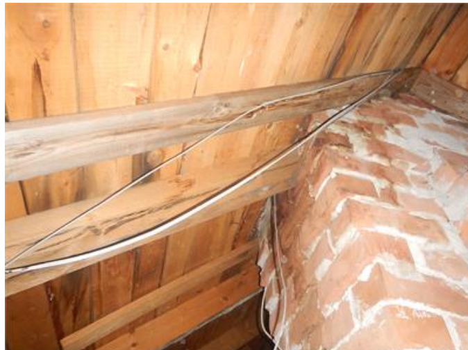
Fuktpåverkan på underlagstak vind.
