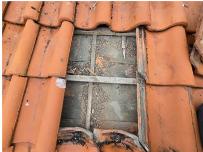
Äldre underlagspapp med mycket skräp under pannor
