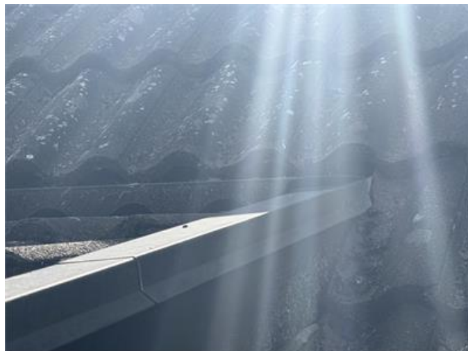
Glipa noterades vid vattplåt på takkupan. Missfärgningar finns på underlagstakets insida i området.
