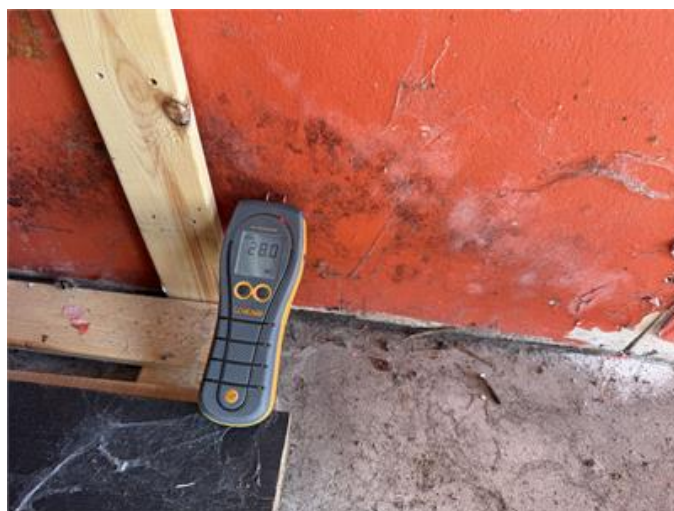
Missfärgning noterades på vägg i garaget. Förhöjda fuktindikationer påvisades i området.
