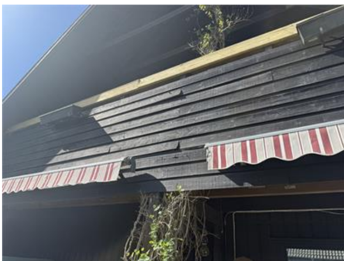
Panel på balkongräcket har lokalt lossnat från infästning.
