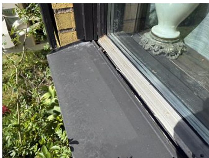
Fönsterbleck lossnat från infästning.
