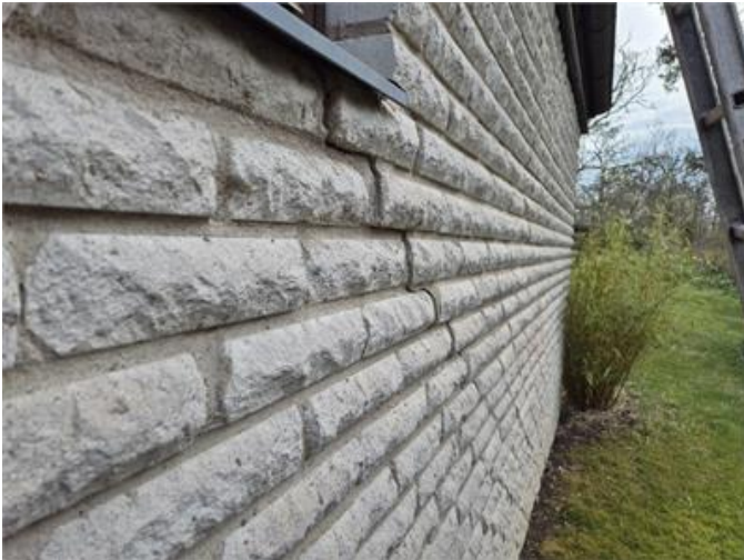
Större sättning och spricka i fasad till garage.
