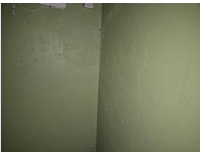
Putssläpp och hög fukt mot källaryttersvägg.
