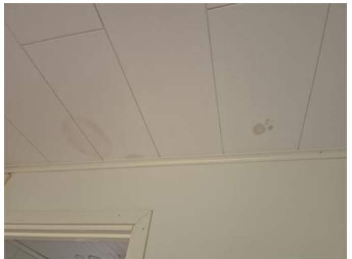
Fuktfäckar i tak, sovrum.
