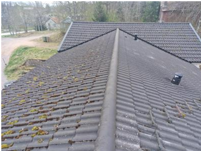
Tak, översiktsbild, mossa på pannorna.
