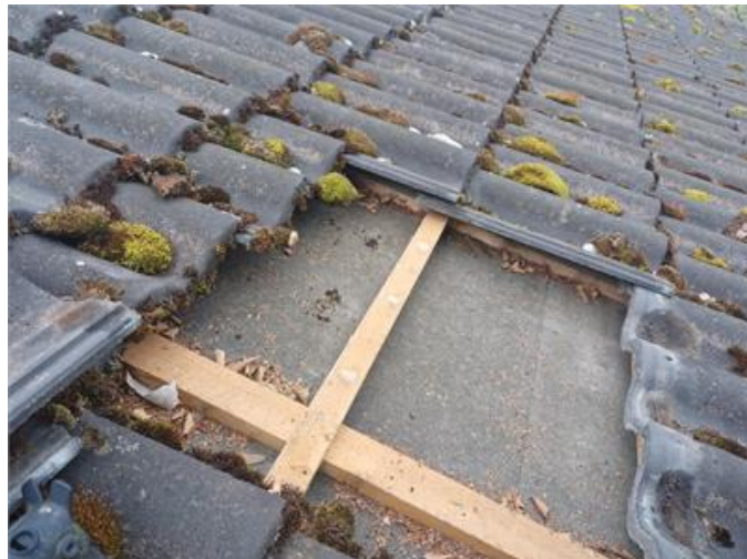
Tak, löv och frömjöl under pannorna.
