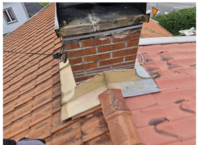
Tak och Skorsten, takplåten taklyft nertrampad med stående vatten, fogsläpp i skorstenen.
