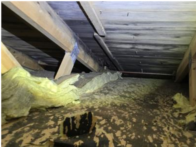
Nockvind: Mikrobiell påväxt/missfärgning.
