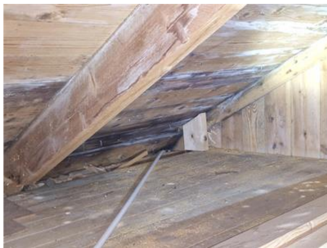
Nockvind, mikrobiella missfärgningar i underlagstaket.
