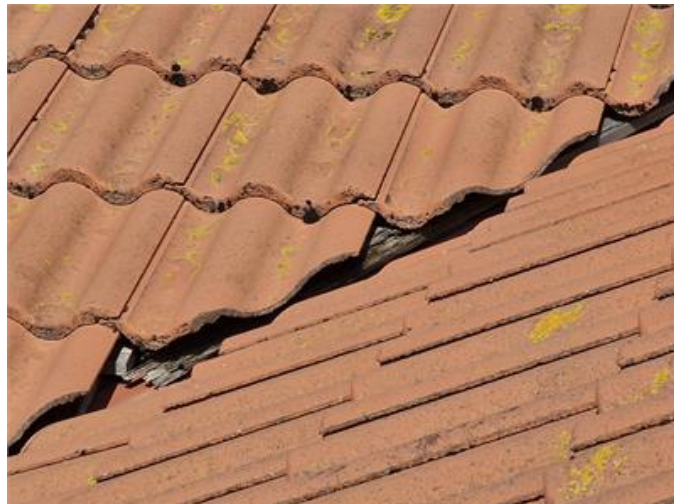
Tak, läkt rötskadad i rännal.
