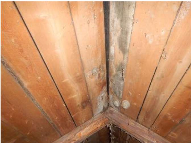
Fuktfläck underlagstak vind.
