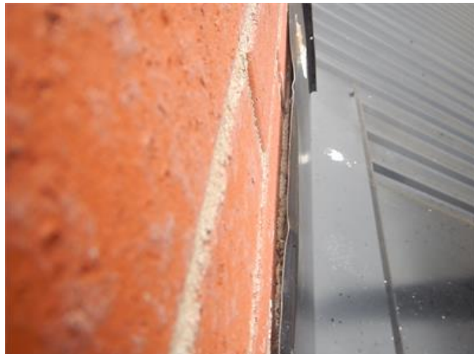
Otäthet mellan murstock och skorstensbeslag.
