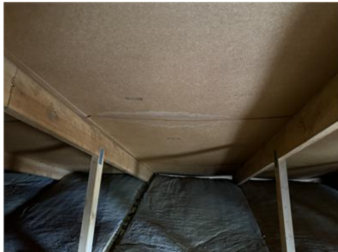
Missfärgningar förekommer på underlagstaket.
