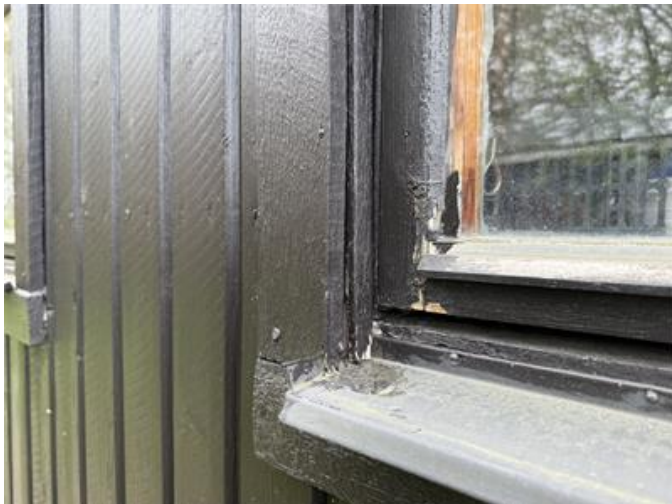
Glipor förekommer mellan fönster och fönstersmyg (vidbyggd del).
