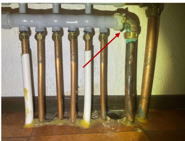
Bild 6: Invändigt, Entréplan, Klädkammare 1, Vattenledningar/rörkopplingar är ej placerat i fördelarskåp med möjlighet till avrinning till ett fuktsäkert utrymme och ett pågående läckage noterades.
