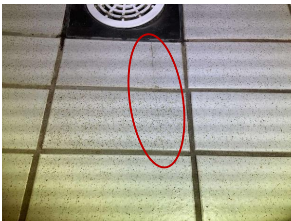
Bild 8: Invändigt, Entréplan, Våtrum 1, Förekommer sprickbildningar på några klinkerplattor i duschplatsen.
