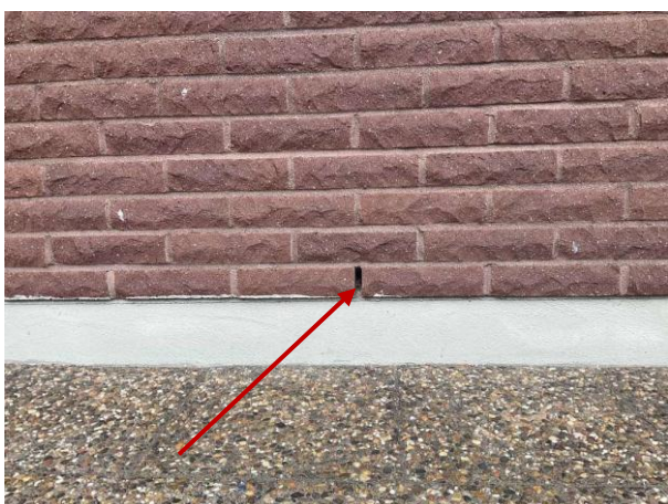
Bild 3: Utvändigt, Fasad, Nät saknas i stötfogar på tegelfasaden.
