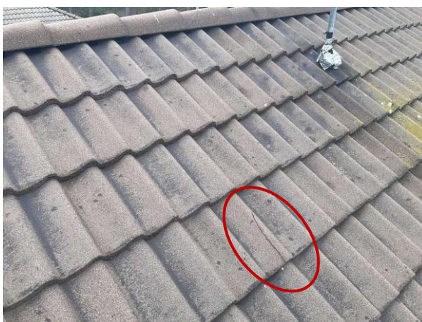
Bild 4: Utvändigt, Yttertak, Noterades en sprucken takpanna vid stickprovskontroll.
