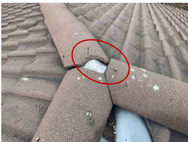
Bild 5: Utvändigt, Yttertak, Vissa infästningar är ej ordentligt nerslagna vidnockpannor.
