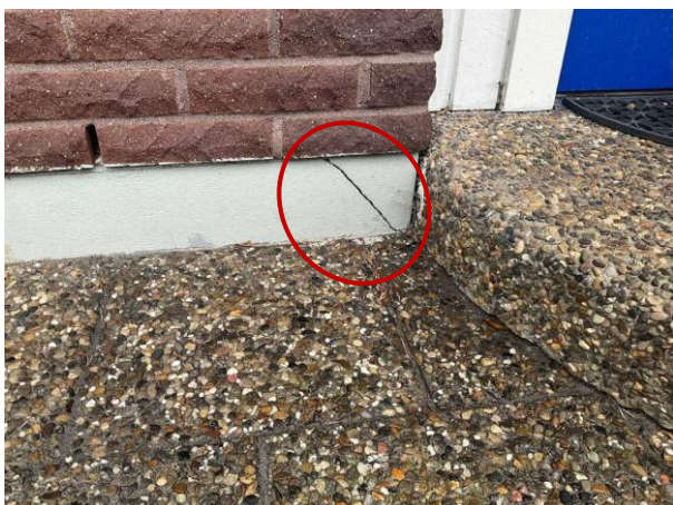
Bild 1: Utvändigt, Grundläggning, Sprickbildningar, missfärgningar och färgsläpp finns på delar av sockel/betongplatta.
