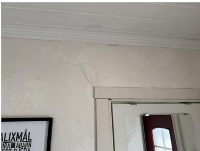
Ojämnhet/spricka i vägg i hallen.
