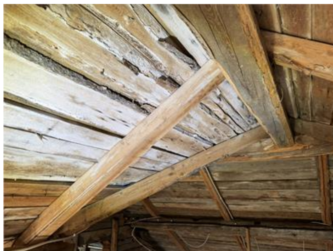
Mikrobiell påväxt på underlagstak i vindsutrymme.
